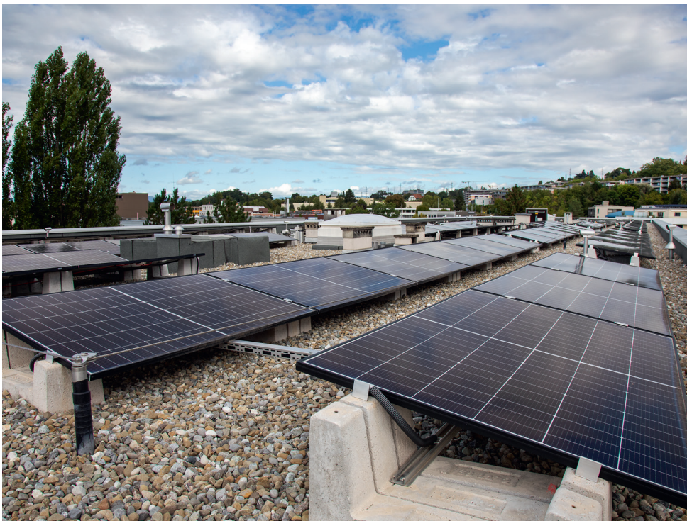
Solarfelder auf dem Dach der Liegenschaft Entre-Bois 57-59 in Lausanne
