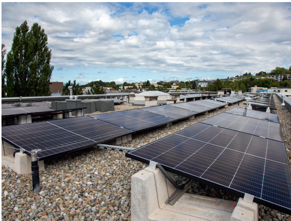
Champs solaires installés sur le toit de l'immeuble Entre-Bois 57-59 à Lausanne
